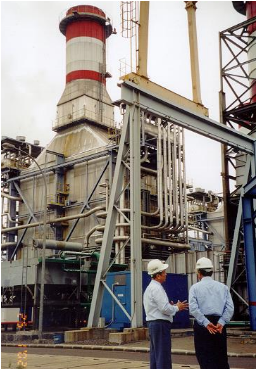
Heat-Recovery Steam Generator PLTGU Tambak Lorok Semarang dari Unit PLTG 115 MW.
